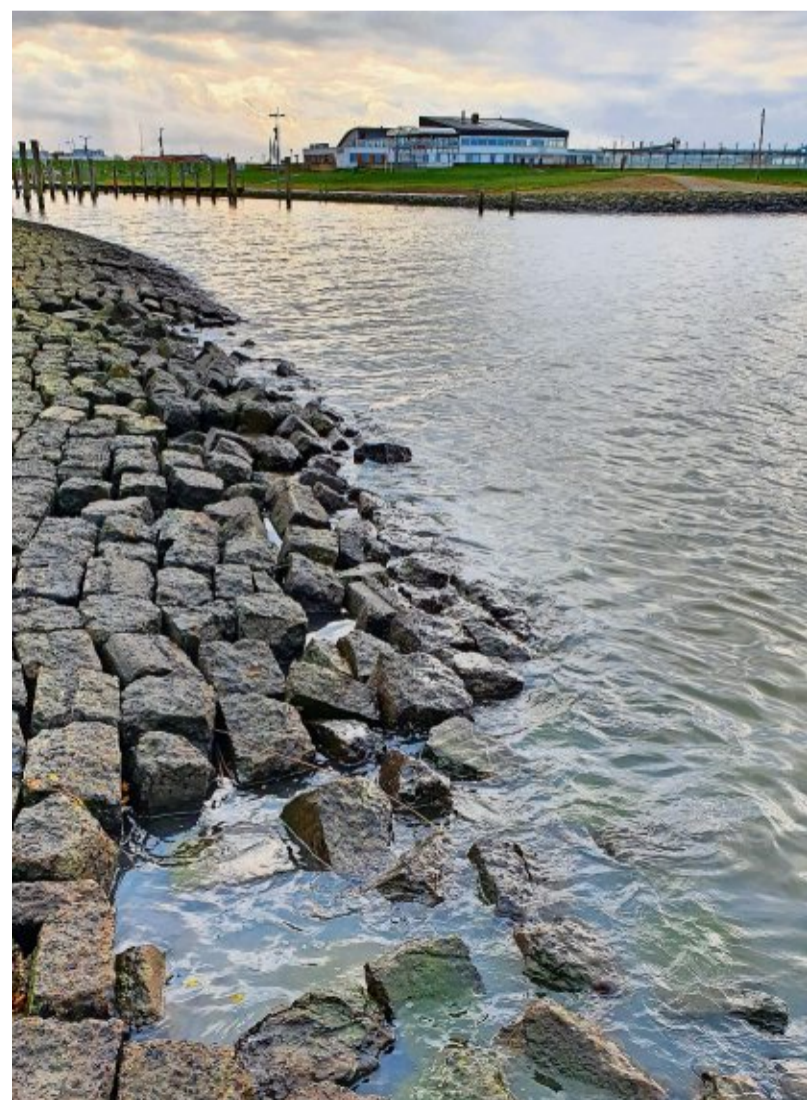
Das Deckwerk zur Befestigung der Uferkante vorm Dorum-Neufelder Kutterhafen hat sich gelöst. Im Frühjahr soll die Kante erneuert werden.
